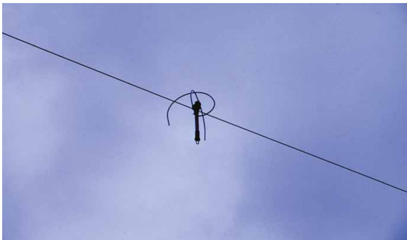
Esempio di evidenziatore visivo apposto su cavo aereo.
