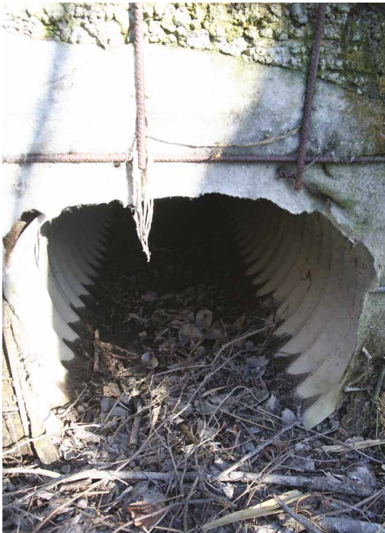
Particolare di tubazione senza grata.
